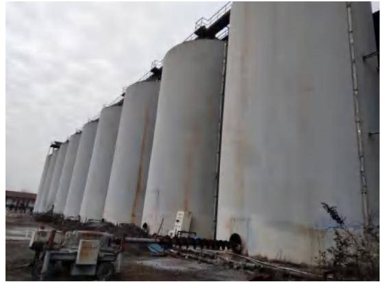
浸泡、固液分离罐
