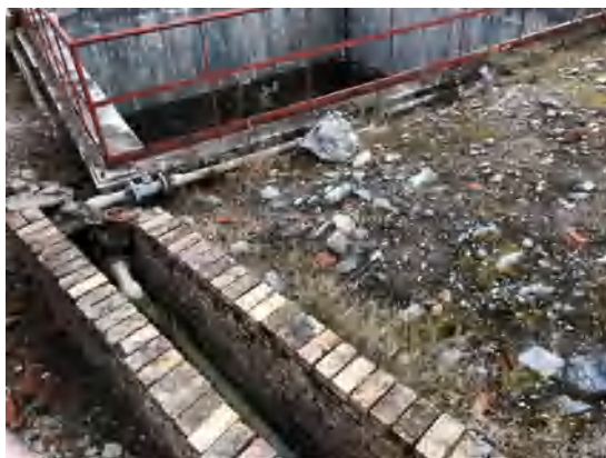
废水输送管道
