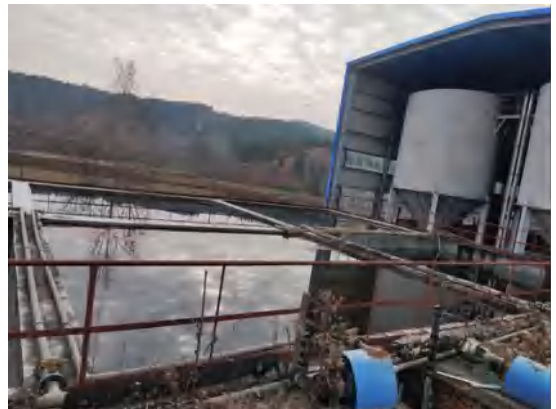
应急池及废水循环池
